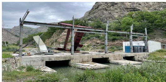
Şəkil 1. Laçın rayonu Hocazsu çayı üzərində tikilmiş və dağıdılmış KSES binası.
